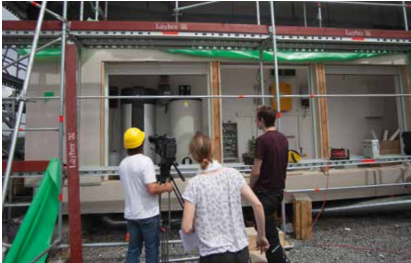
Ansicht vom Technikraum mit Wärmepumpe und Wechselrichter
